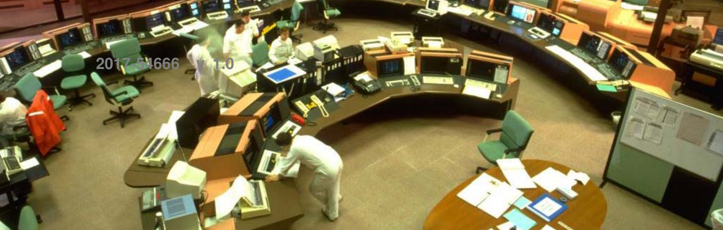
Salle de conduite centralisée (située dans le bâtiment central)
