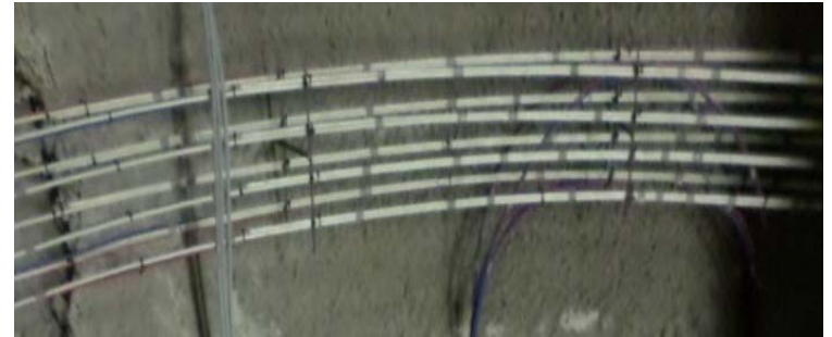
Exemple de fibres optiques posées dans une galerie du Laboratoire souterrain de Meuse/Haute-Marne
