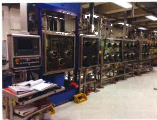
Figure 13 : Atalante : ligne de boîtes à Gants (BAG) du broyage au pressage
