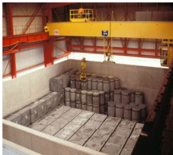
Manutention de colis en béton dans un ouvrage de stockage du centre de l'Aube
