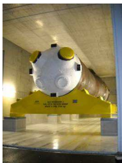
Figure 12 : Entreposage de décroissance d'un GV usés sur CNPE
